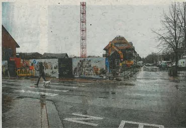
Het gebouw komt op de hoek van de Schooldreef en de Kortrijksestraat. © MVN
