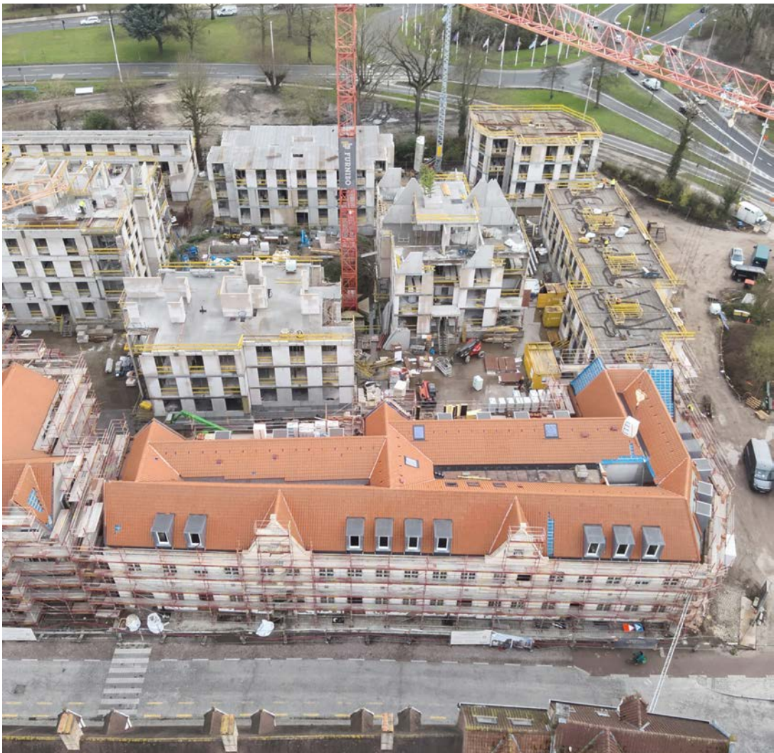
Boevrie wordt voorzien van een BEO-veld met 120 boringen tot 150 meter diep.
