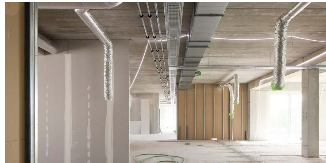
Mede dankzij energie-efficiënte installaties is het gebouw klaar voor de toekomst.
